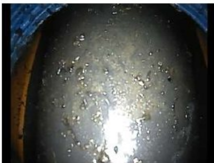
3) End Point gully3
