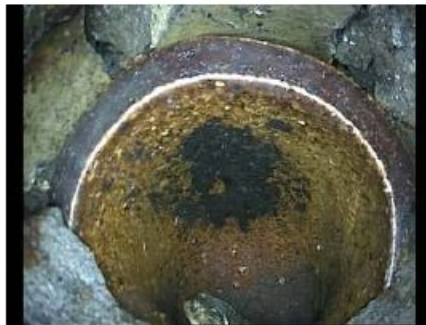
2) End Point gully2
