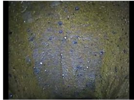
2) End Point gully1
